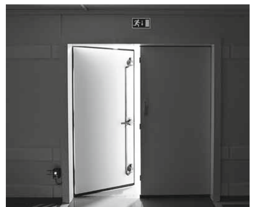
Fig. 3: éclairage de secours (luminescent).
