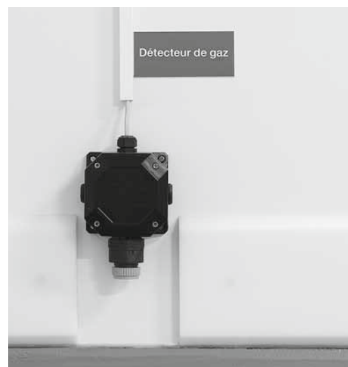
Fig. 7: système de détection des gaz.
